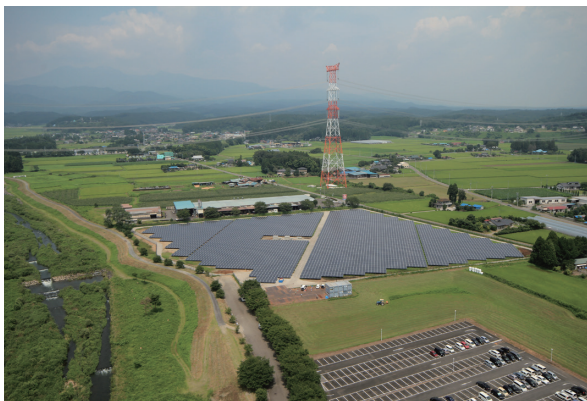
メガソーラー発電所
