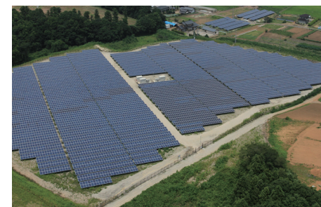
LSつくば房内発電所
