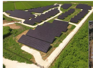
LS藤岡A発電所
