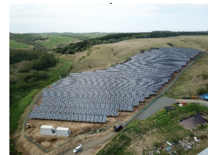
根室市花咲港太陽光発電所（北海道）
