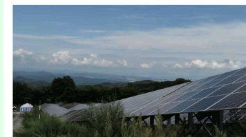
LS鳥取大山発電所(発電容量:14MW)
