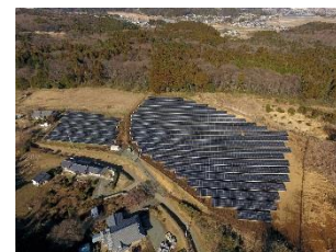
LS高萩発電所 パネル出力：1.19MW FIT価格：32円/kWh
