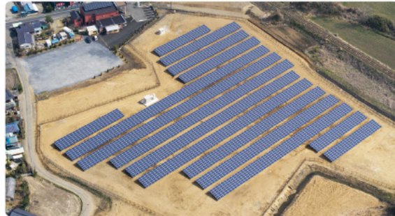
LS筑西発電所
